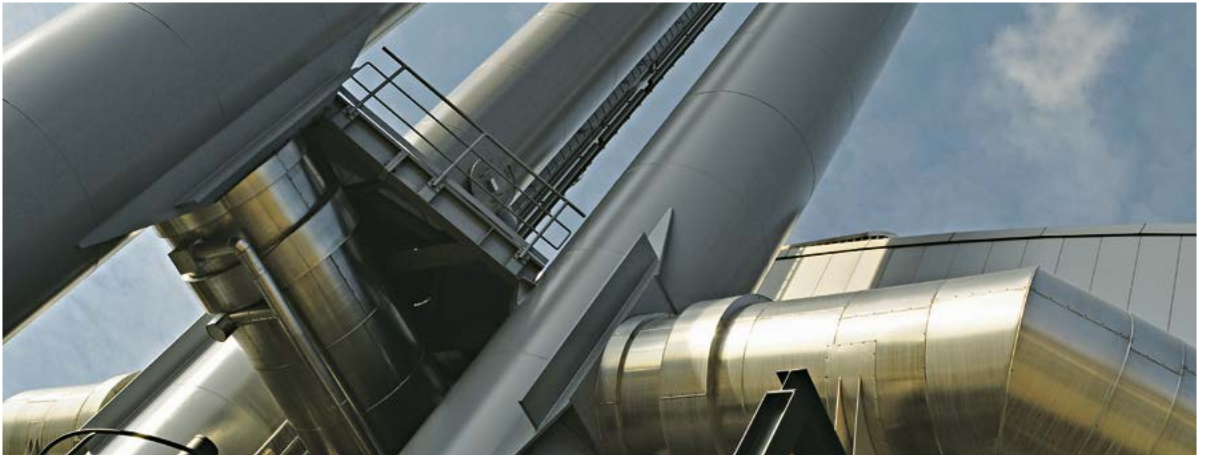
Nachhaltige Wärme: Innovative Wärmenetze spielen für die Klimaschutzziele eine wachsende Bedeutung. Im Bild ist ein Heizkraftwerk, das die Hamburger Hafencity versorgt.
